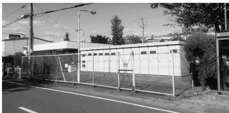
共同受電設備
